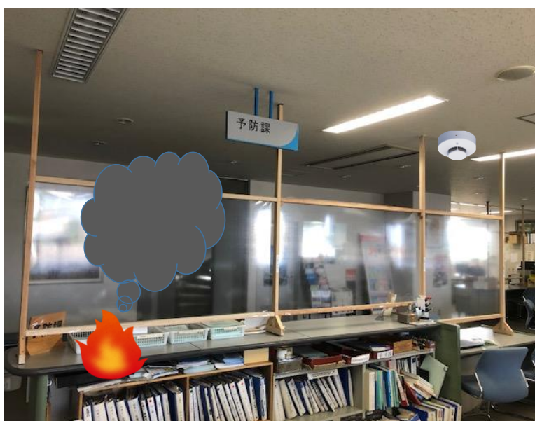
自動火災報知設備が適切に感知できる例
