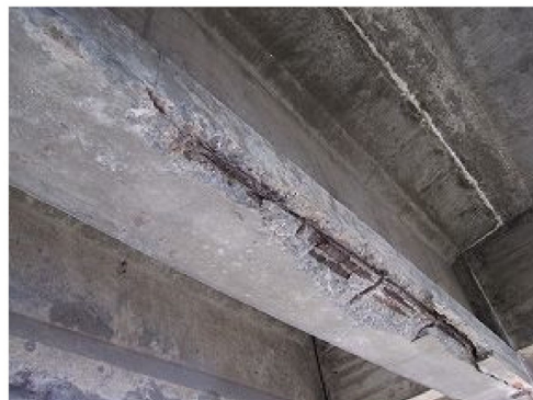
コンクリートの剥落
