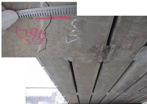
コンクリートのひびわれ
