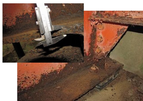
塗装の劣化及び鋼材腐食
