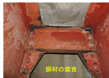
写 4-1 損傷事例 (健全度Ⅱ～Ⅲ)
