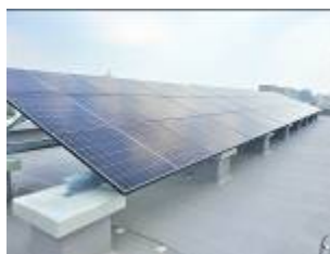
太陽光発電(糸島市庁舎)
