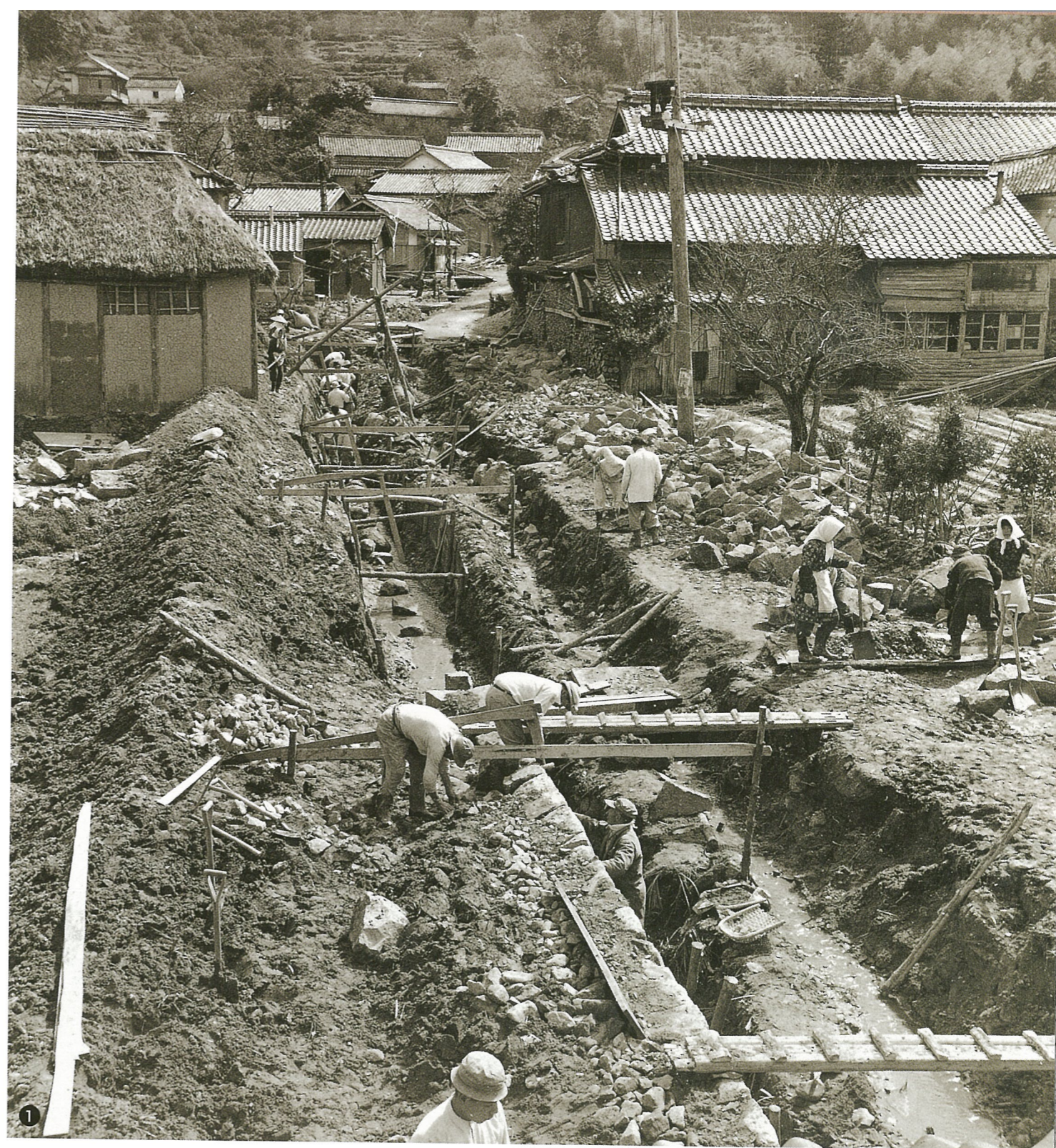
写真① 波呂の区役風景。地域総出で道路や排水路などの補修、改修に当たりました。昭和33年（1958）に撮影されたものです。
