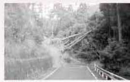
土砂崩れにより通行止めとなった道路(白糸地区)
