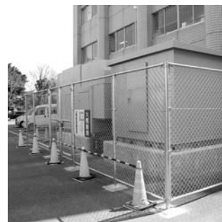
市役所本庁舎新館横の発電機
