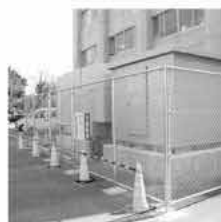
市役所本庁舎新館横の発電機
