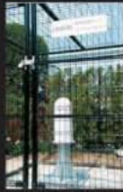
糸島総合庁舎に設置されたモニタリングポスト
