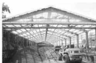
糞尿(かくはん)発酵させるたい肥化施設
