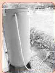
可也公民館に設置されている雨水タンク
