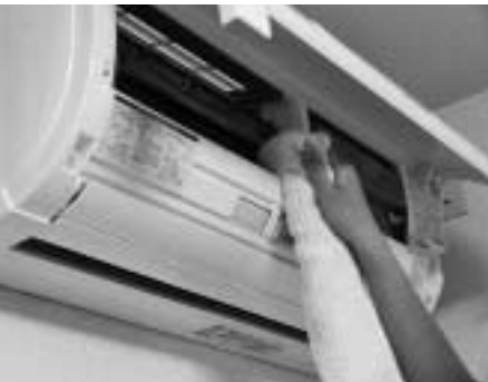
エアコンを清掃することで冷却効率アップ
