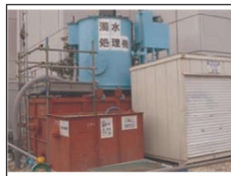
濁水処理装置設置例
