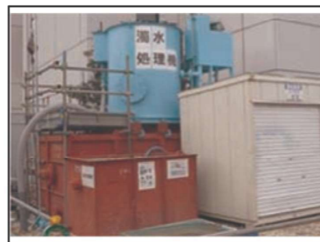
濁水処理装置設置例
