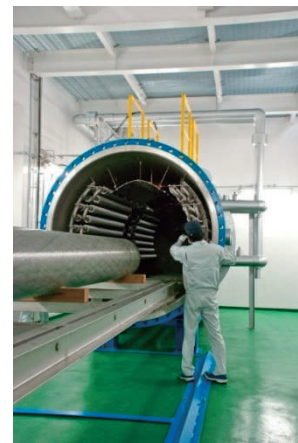
水素エネルギー製品研究試験センター 高圧水素試験施設
