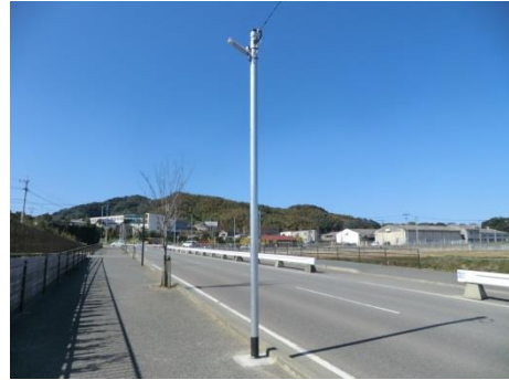
専用柱に添架してある防犯灯
