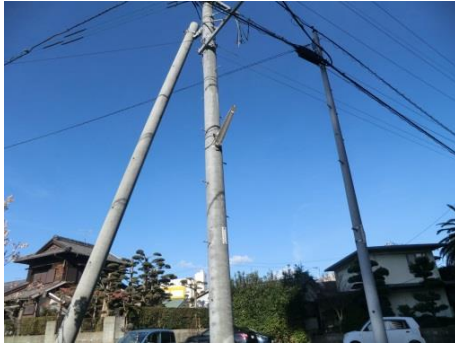
電柱に添架してある防犯灯
