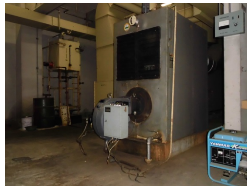
設備機器の老朽化
