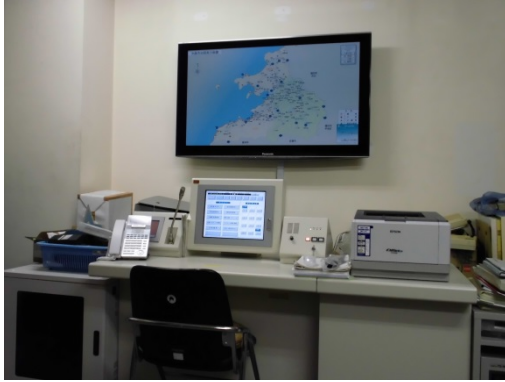
本館 2 階にある防災無線室
