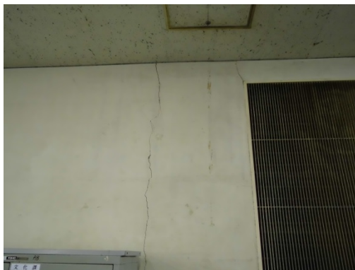
内壁のひび割れ
