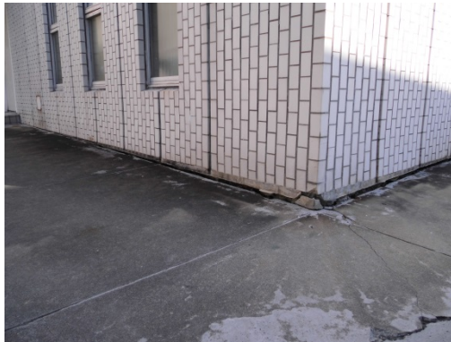
外壁のひび割れ
