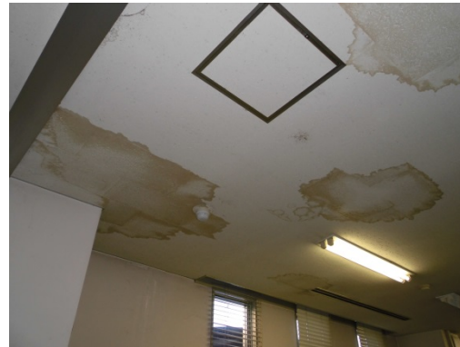
漏水による天井のシミ
