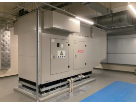
自家発電設備
