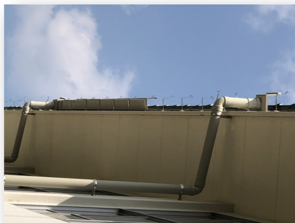
台風により外れた雨樋
