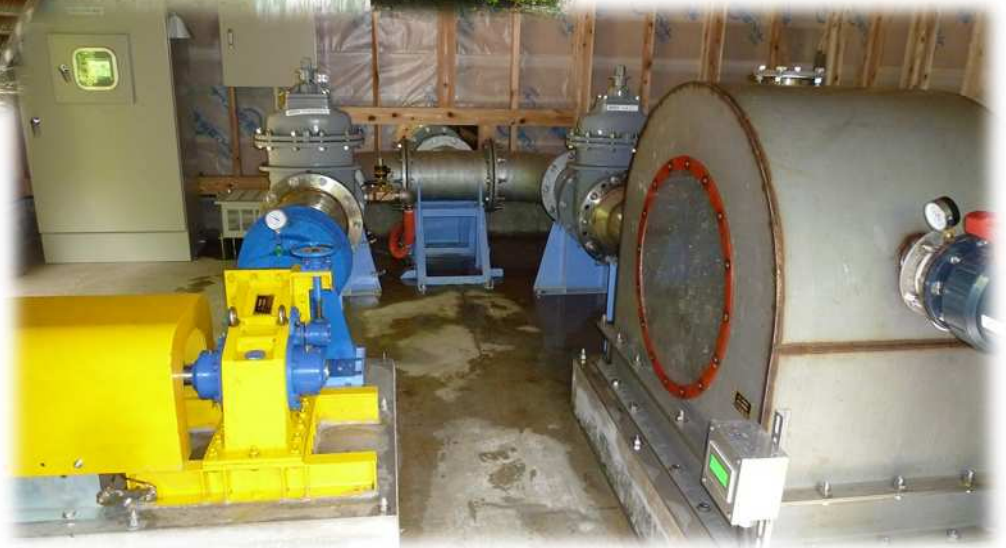
白糸の滝小水力発電所
